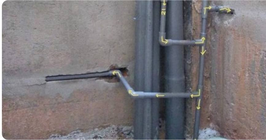
Hình ảnh: Ống đi nổi được đánh dấu
